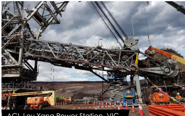
AGL Loy Yang Power Station, VIC
